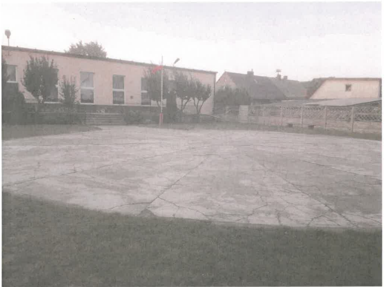
Fotografia przedstawiająca stan płyty betonowej przy sali WOK w Mieszkowie.
